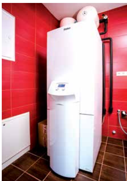
Tepelné čerpadlo je umiestnené v technickej miestnosti domu.
