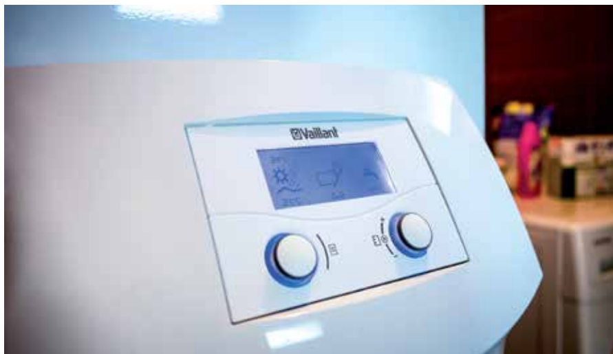
Ovládací panel tepelného čerpadla geoTHERM plus
