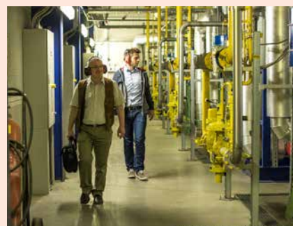
Exkurzia v kogeneračnej teplárni s centrálnou výrobou chladu z tepla.
